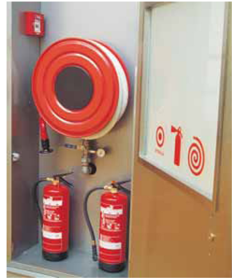
Equipos fijos y móviles de extinción
