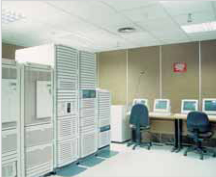
Equipos de extinción automática en salas informatizadas
