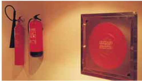
Grupos de extintores y sistemas de extinción fijo
